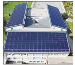
Die Solaranlage auf dem Dach des Oberstufenschulhauses. [Bild zvg]
